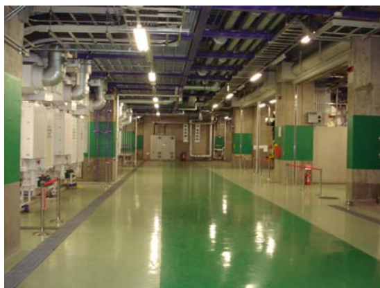
<地下3階設備室>
