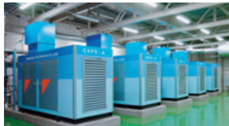
80kW × 5基の発電機
