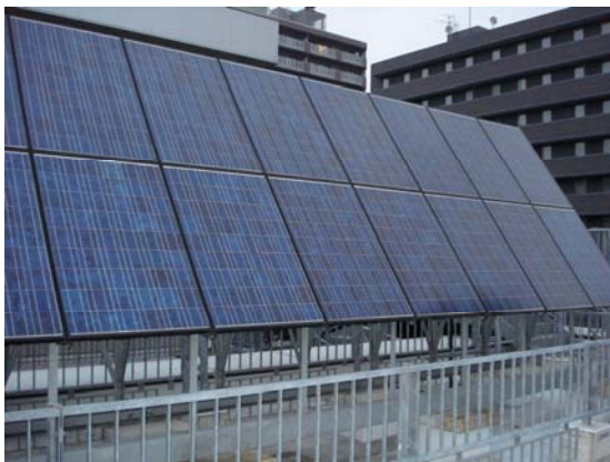
<太陽光パネル>
