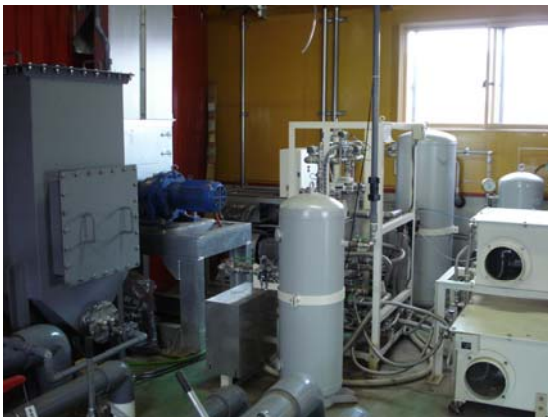
<バイオガスプラントの内部>
