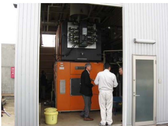
<チップボイラ (700kW)>
