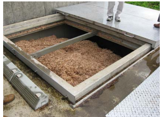
<チップの貯留設備>
