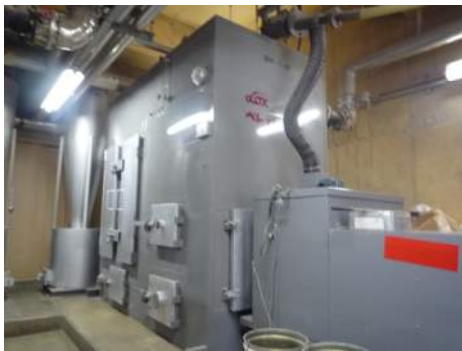
ペレットボイラー
