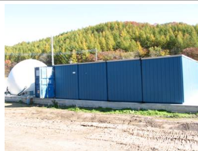
写真4-4-1 足寄町のバイオガスプラント (NEDO補助事業にて設置)
