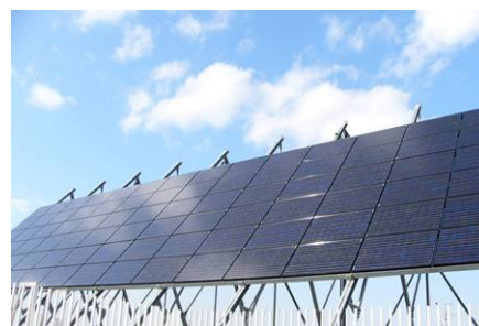
写真 4-1-3 屋上南端に設置された太陽光発電システム
