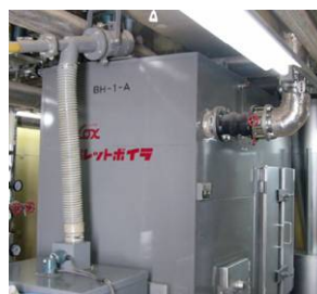
写真 4-6-6 ペレットボイラー
