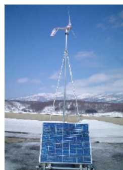
写真 4-3-4 蘭越高等学校の ハイブリッド発電システム
