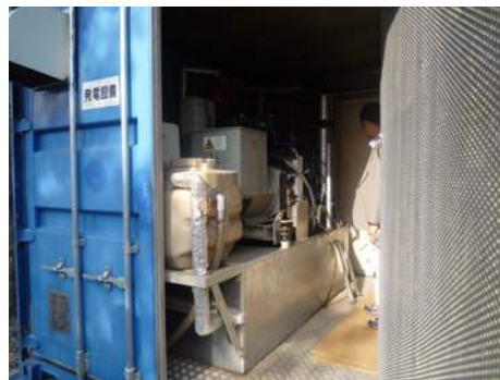
発電設備室(コンテナを利用)
