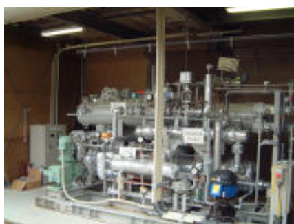
写真 4-9-1 福島県熱塩加納村 温泉水温度差発電システム
