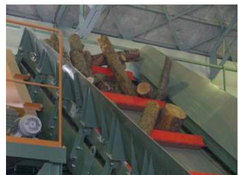
粉碎機に投入されオガ粉にする
