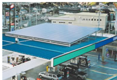
写真 4-1-2 大型施設用太陽光発電システム 【出典】シャープ(株)HP
