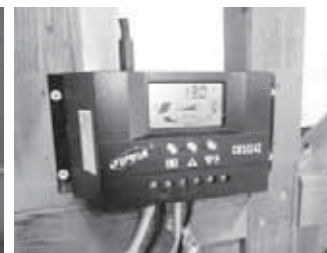
充電のためのチャージコントローラー
